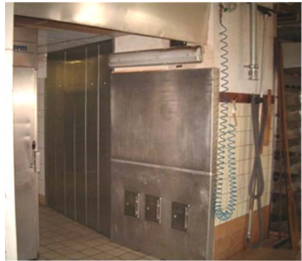
Abb. 4: Die Wärmerückgewinnungsanlage ist mit einer individuellen Verkleidung in die vorhandene Bausubstanz eingepasst
