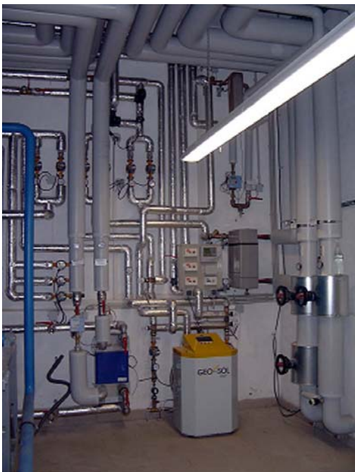
BHKW und Kälteanlage
