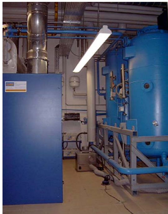
Reenergieeinheit zur Befüllung und Entnahme aus dem Wärmespeicher
