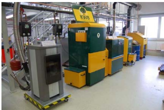
Abb. 1: Blick auf die Anlagentechnik
