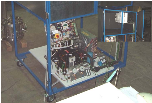
Abb. 1: Der Versuchsstand mit Anlagensteuerung und Verflüssigungsansatz
