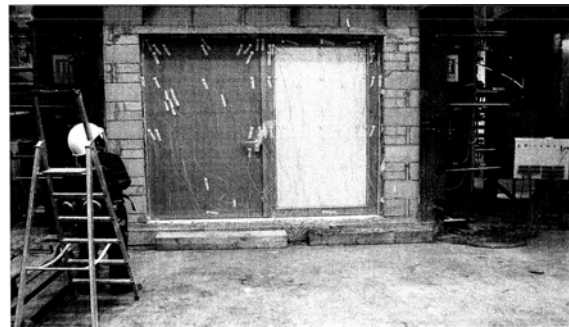
Abb. 1: Brandschutztüren (Holz & Glas)
