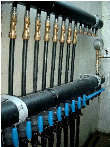
Sammler der Heizungsanlage
