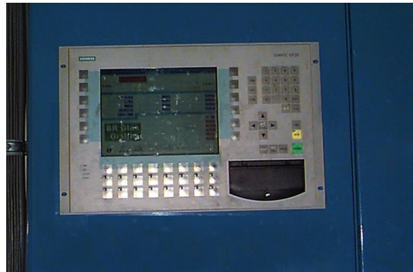
Operator-Panel im Schaltschrank
